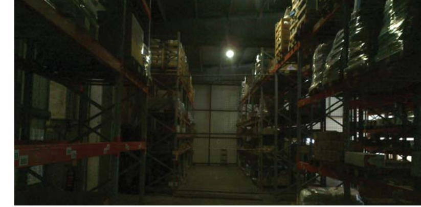
Boş depo alanlarında 30% aydınlatma seviyesi (35 W güç).
