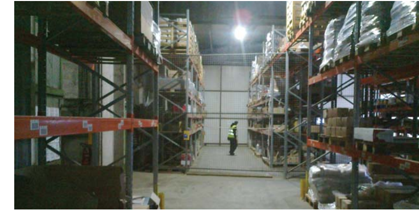
Personellerin, forklift ve digger makinaların bulunduğu alanda 100 % aydınlatma seviyesi (120 W güç).
